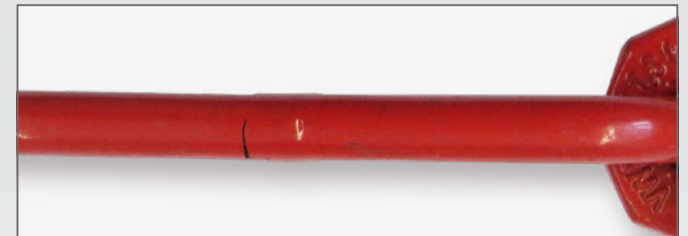
Pęknięcie ogniwa łączącego
